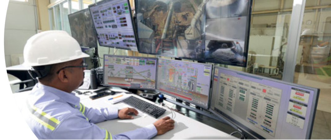
Artemio Vera | Cogeneration Supervisor – Ingenio Adolfo López Mateos
